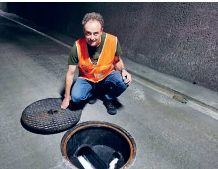
Urs Graf überprüft eine Leitung, in der kalkhaltiges Bergwasser aus dem Sicherheitsstollen abgeführt wird.
