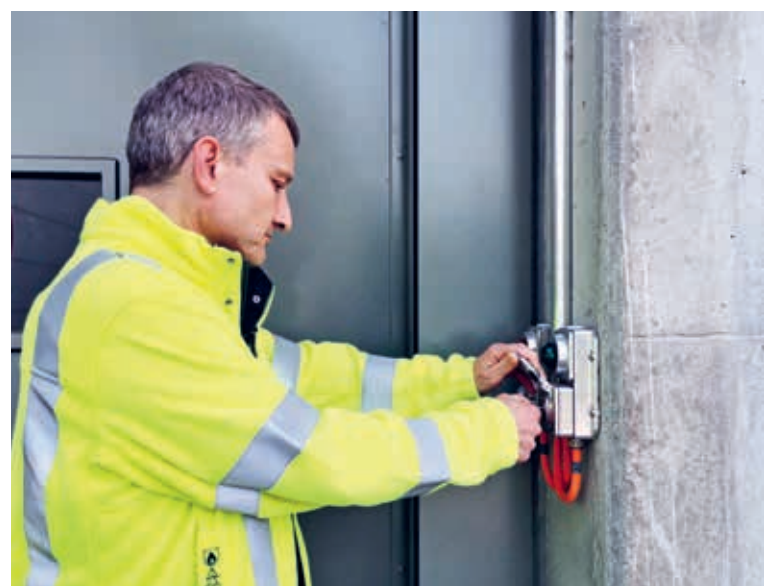
Vor Wartungsarbeiten schaltet Daniel Märki die Überwachungsanlage aus.
